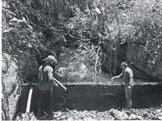
Tomo, Punto de captación.
