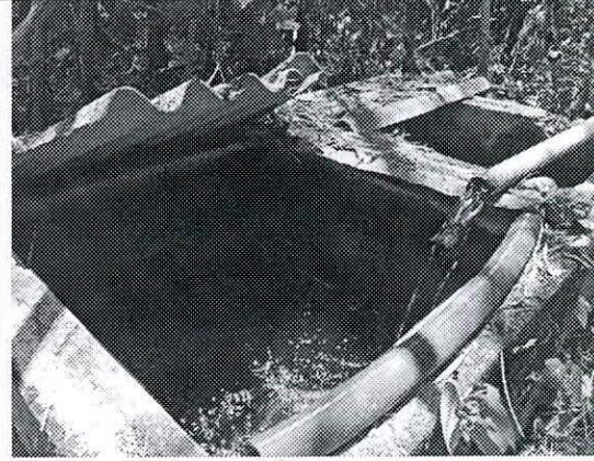
Tanque de almacenamiento 1
