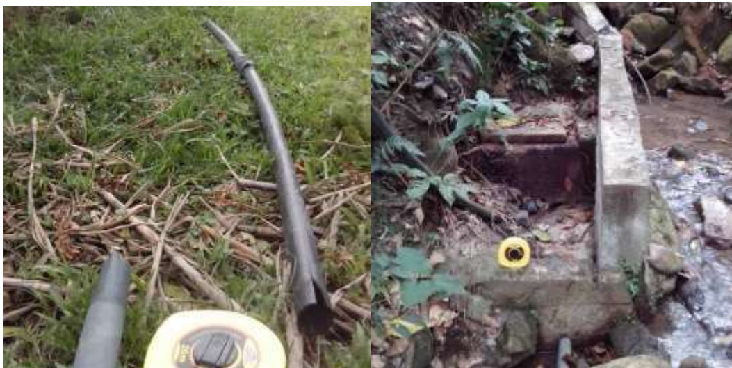
Fotografía 17. Manguera al interior de los predios del señor Cesas Montealegre y Fotografía 18. Captación presuntamente a nombre del señor Octavio Durán.
