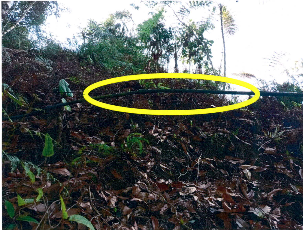
Fotografía No. 2 Red de conducción
