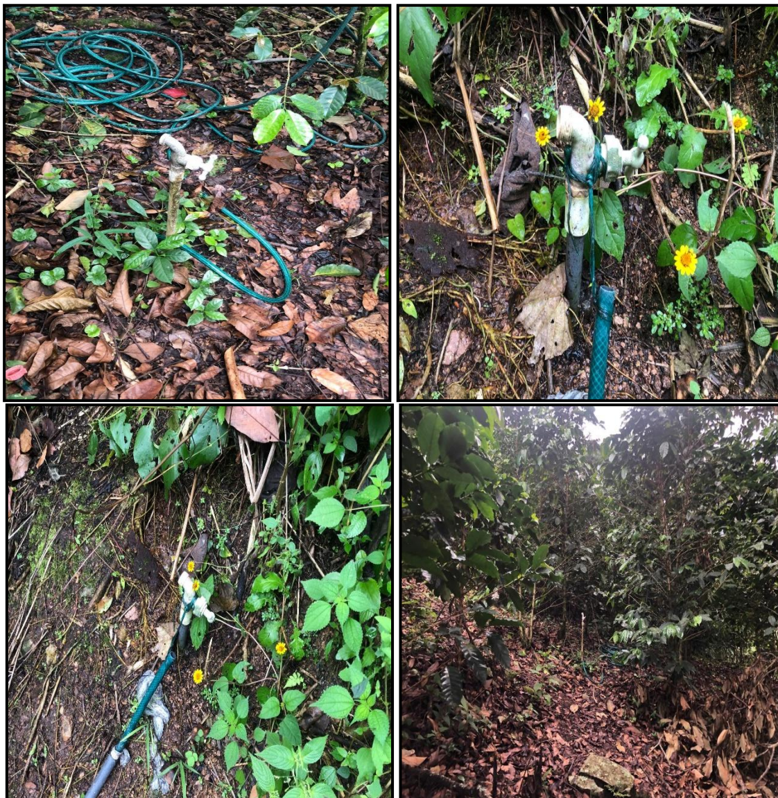
Fotografías 7, 8, 9, y 10: primera llave terminal, desde donde se conecta el sistema de riego por aspersión- Predio El silencio - vereda la Palma – Tarqui - Huila
