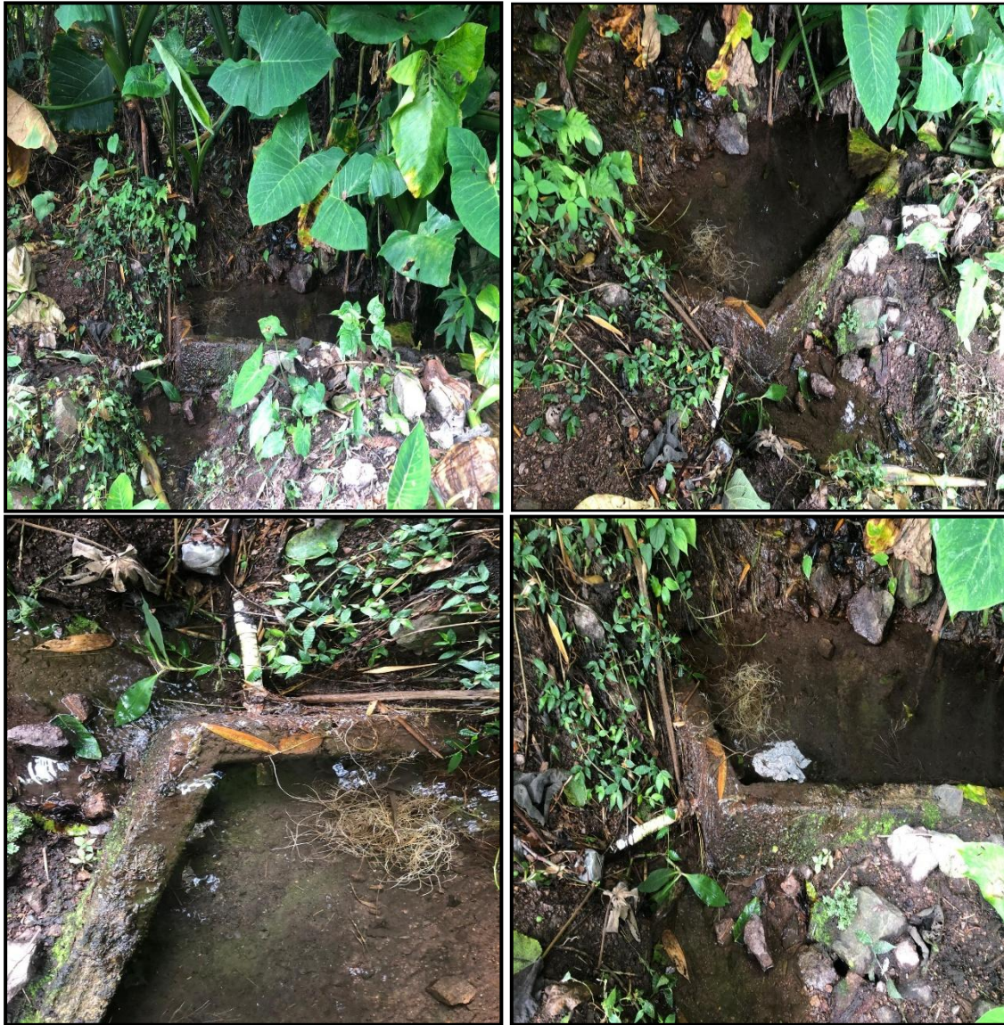
Fotografías 3, 4, 5, y 6: Punto de captación, dique, conducción del recurso, vereda la Palma – Tarqui - Huila
