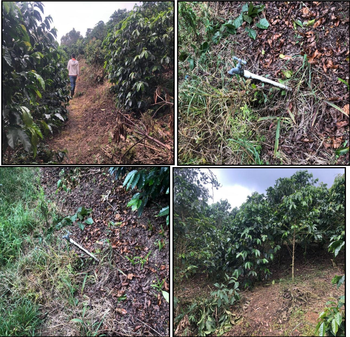
Fotografías 14, 15, 16 y 17: primera llave terminal (3), desde donde se conecta el sistema de riego por aspersión- Predio El silencio - vereda la Palma – Tarqui - Huila
