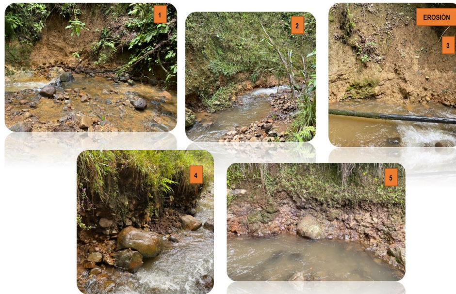
Imagen 4. Procesos erosivos sobre el cauce principal de la quebrada La Chorrera en el Tramo 1 vereda Yarumal.
