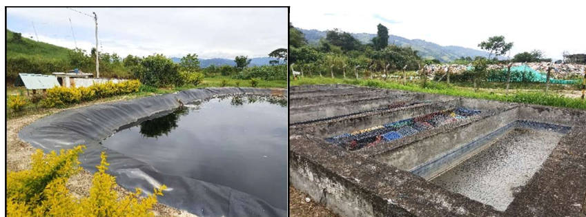
Biorgánicos del Sur – Sistema de tratamiento de lixiviados
