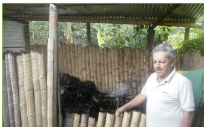
Adecuación Fosa de Compostaje Beneficiario Ascencio Villareal de la Vereda Pantanos del Municipio de Timaná
