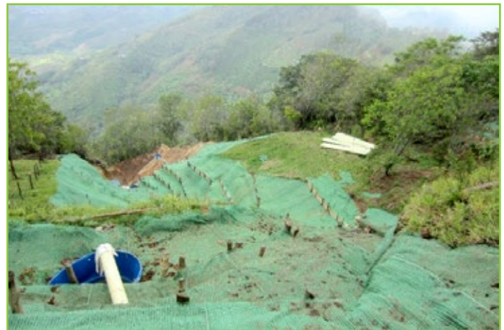
Obras de bioingeniería en proceso erosivo y de remoción Miraflores (Vereda Palestina), noviembre 2016
