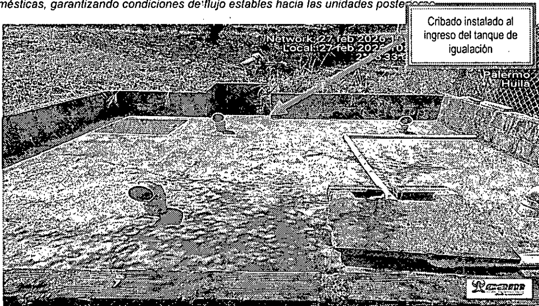
Foto 3: Evidencia fotográfica del tanque de igualación del sistema de tratamiento de aguas residuales domésticas – ARD construido en el Condominio Campestre San Sebastián.
