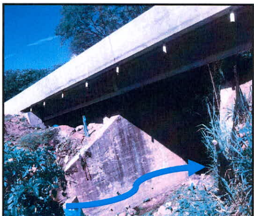
Fotografías 2, 3, 4, 5 y 6: Puente área de encole del afluente zanjón los Loros, afluente a su vez de la quebrada Laberintos, que desemboca al río Magdalena en la margen derecha - ruta - 45-05 - vereda El Espinal – Gigante - Huila
