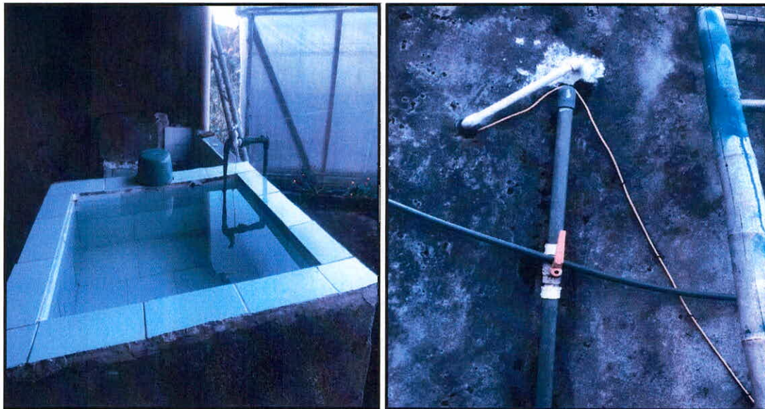
Fotografar No. 7 y 8: tanque dos (2), de almacenamiento del recurso hídrico, PREDIO RURAL LOTE # 1 EL MIRADOR vereda El Socorro - Pital-Huila
