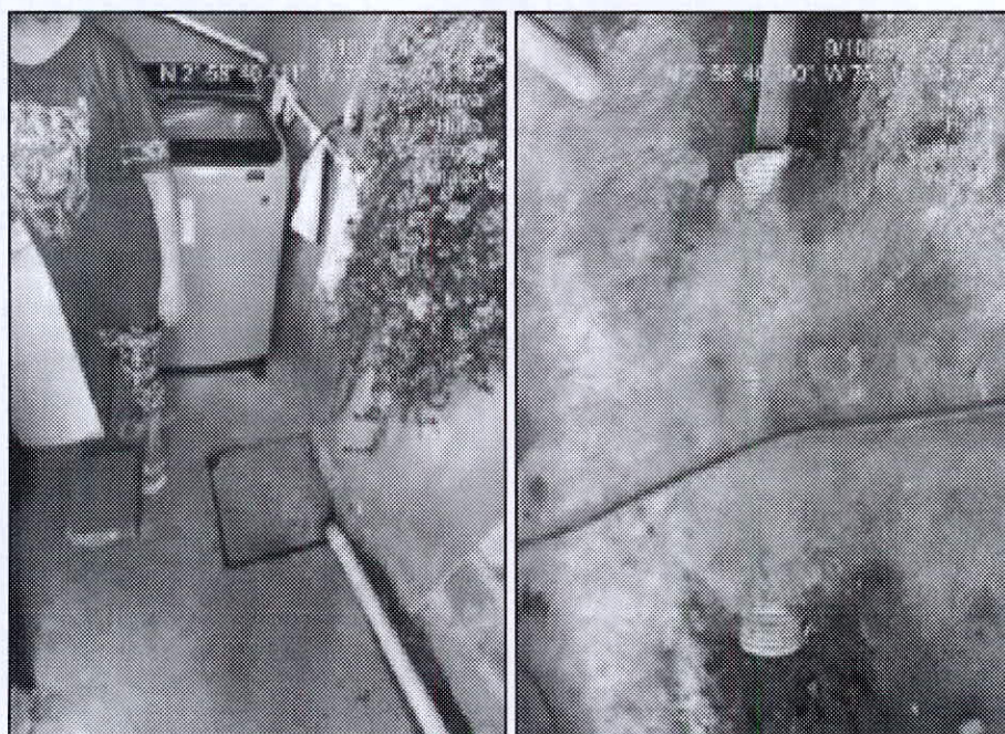
Registro fotográfico No. 3 y 4: Se observa tubería en la cual se conduce el ARD.
