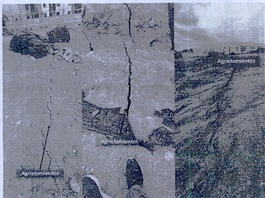
Imagen No. 4: (Imagen 6). Agrietamientos identificados en el relleno que se encuentra en cercanías del proyecto de Torres Alzati. Fuente: Anexo 2.
