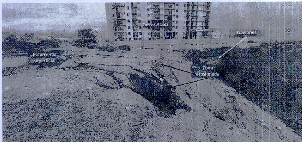
Imagen No. 3: (Imagen 5). Recorrido realizado en el relleno ubicado en cercanías de la Torre Alzati, donde se observa la erosión y la escurrentia superficial. Fuente: Anexo 2.
