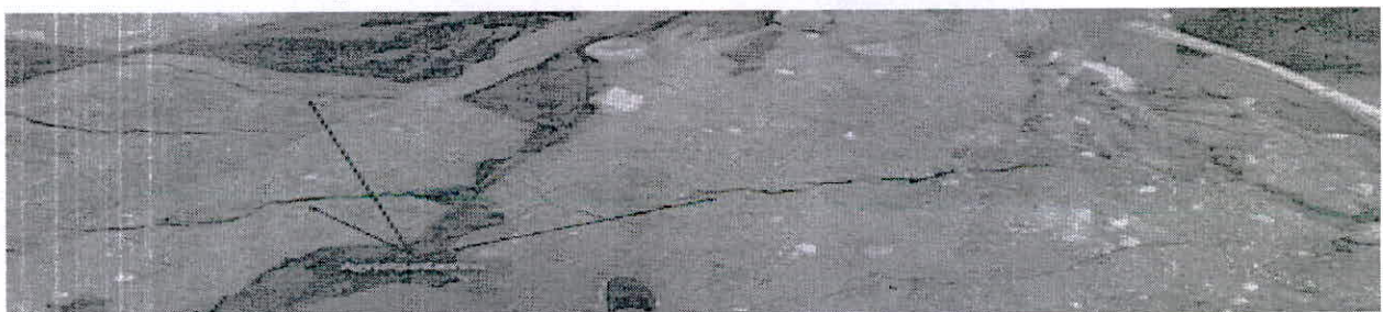
Imagen 4. Agrietamientos identificados en parte del relleno dispuesto en cercanías de la ladera.
