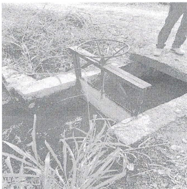
Imagen 3 compuerta plana deslizante
