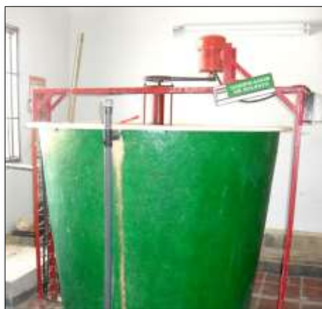
Imagen 6. Sistema de dosificación de químicos - PTAP municipio El Hobo.
