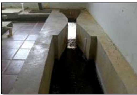
Imagen 3. Canaleta Parshall - PTAP municipio El Hobo
