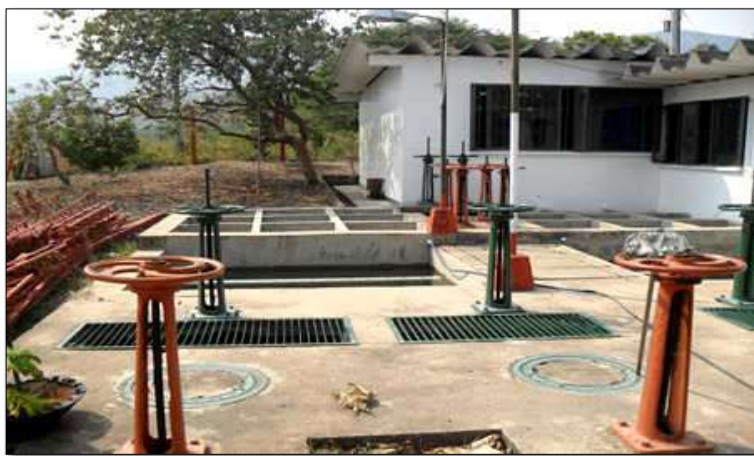
Imagen 7. Compartimientos de filtración - PTAP municipio El Hobo.
