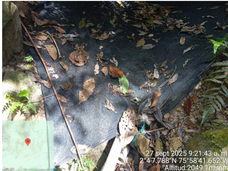
Fotografía No. 4. Punto de captación sobre Nacimiento sin denominación
