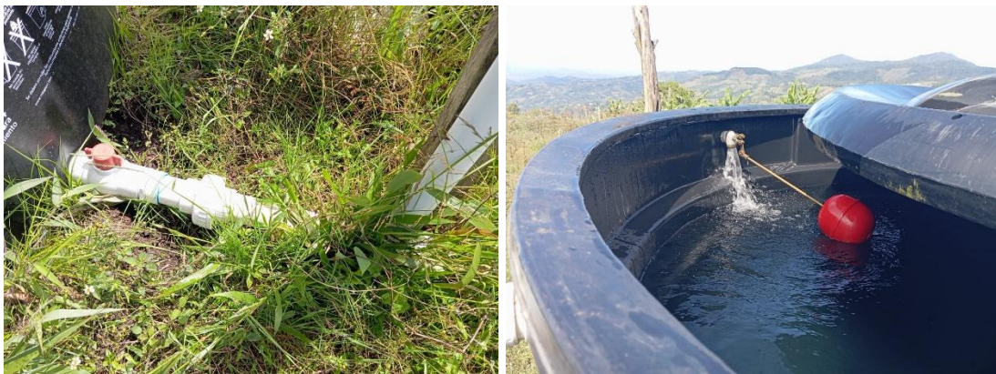
Fotografía No. 12 y 13. Control de llaves y flotadores en los tanques de almacenamiento
