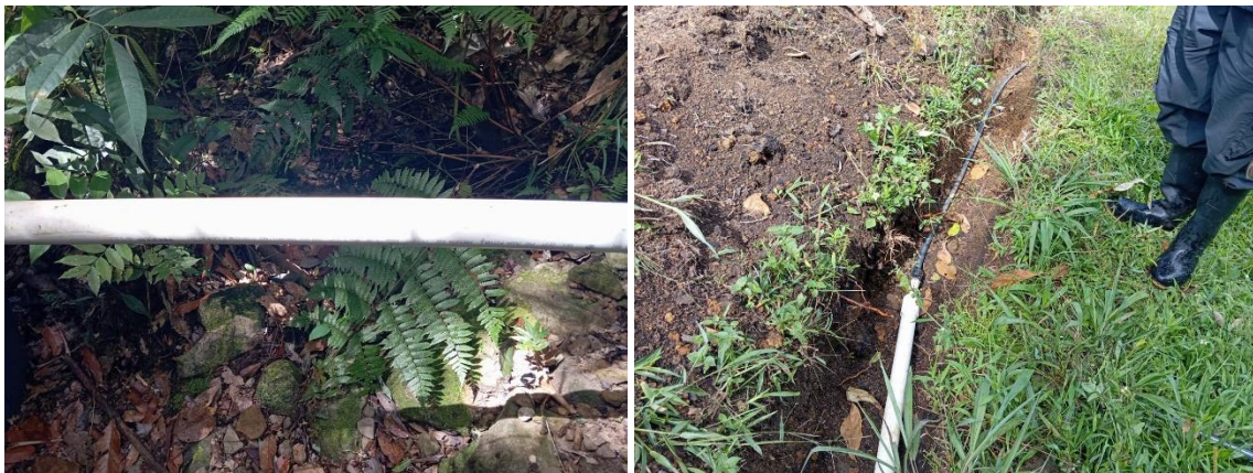
Fotografía No. 7 y 8. Tubería y manguera de conducción
