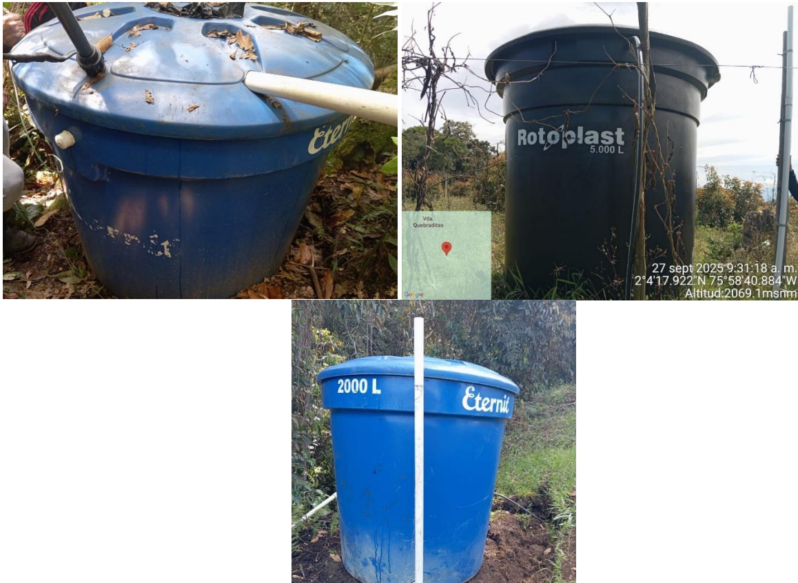
Fotografía No. 9, 10 y 11. Tanques de almacenamiento
