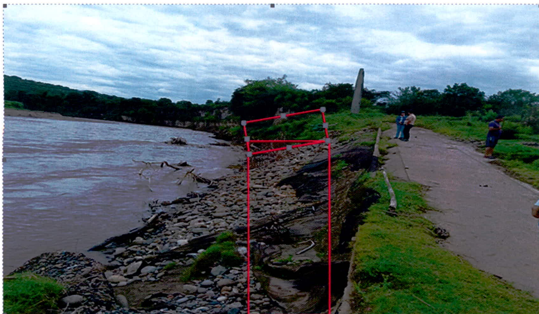
Fotografía 3. Panorámica sitio construcción obra de protección y estabilización de talud mediante geoesteras y geocontenedores Vereda la Cañada, Municipio del Agrado – Huila.
