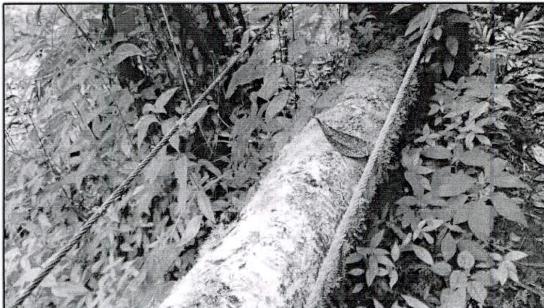
Fotografía No. 3: la línea de aducción por tubería de policloruro de vinilo (PVC) con un diámetro nominal de 8 pulgadas – vereda alto tres esquinas– Gigante (Huila).
