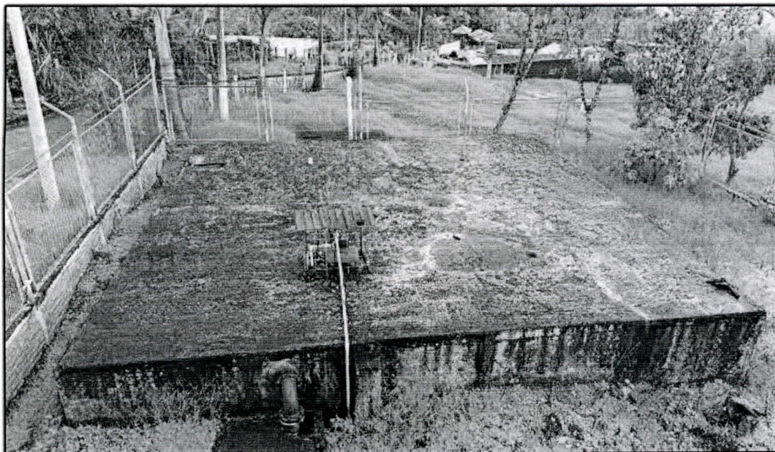
Fotografía No. 7: tanque de almacenamiento de concreto en la PTAP- Vereda tres esquinas– Gigante (Huila).
