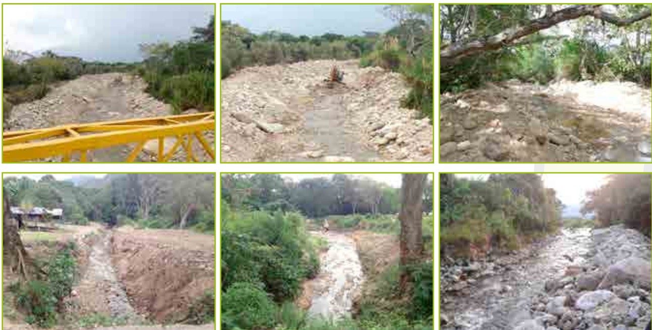
Dragado y Rectificado de Cauce de La Quebrada Rio Frio, Quebrada Piñal, Quebrada La Rivera y Quebrada El Arenoso, zona rural del municipio de Rivera
