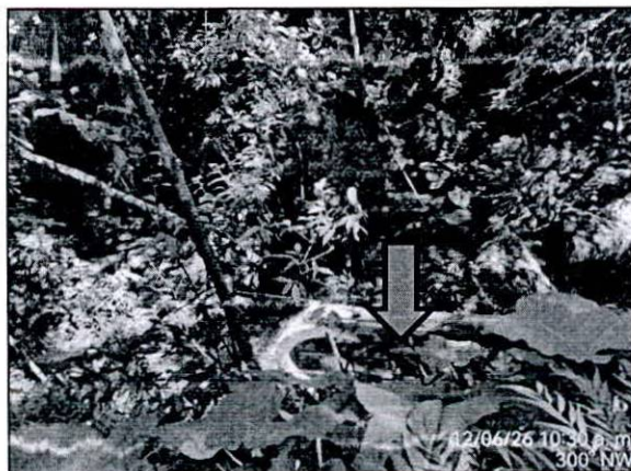
Foto 3. Caída del recurso hídrico desde tubería de PVC de 3" pulgadas de diámetro. Fuente: Propia.
