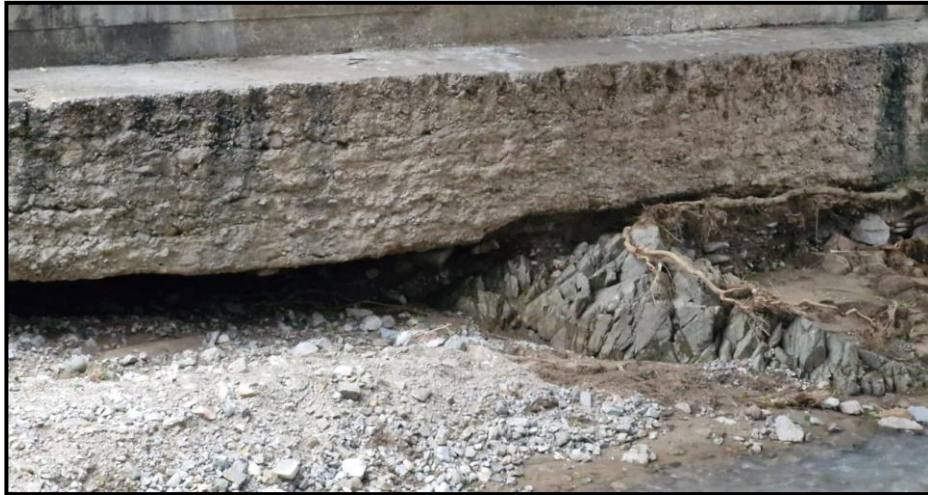
FIGURA 17. Socavación sobre la base de puente Quebrada seco debido a la erosión hídrica
