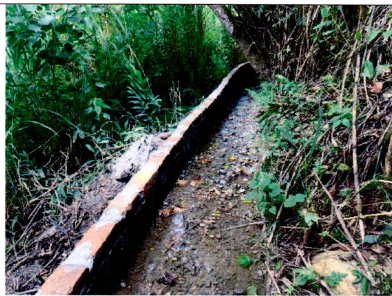
Fotografía 2. Estructura de regulación y control de caudales del canal de aducción, localizada en zona extrapredial
