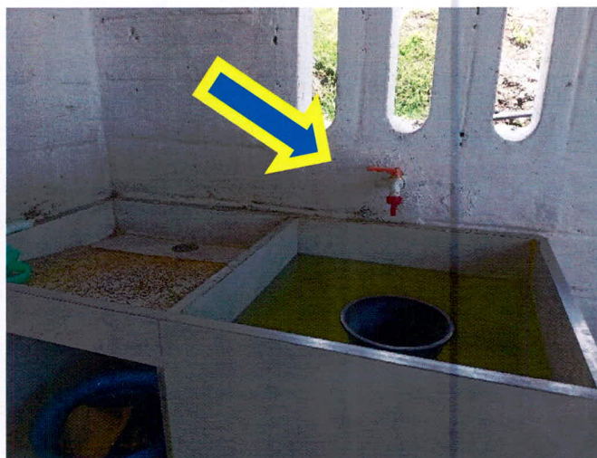
Fotografías N° 10 y 11 Red de conducción de uso doméstico con llaves terminales
