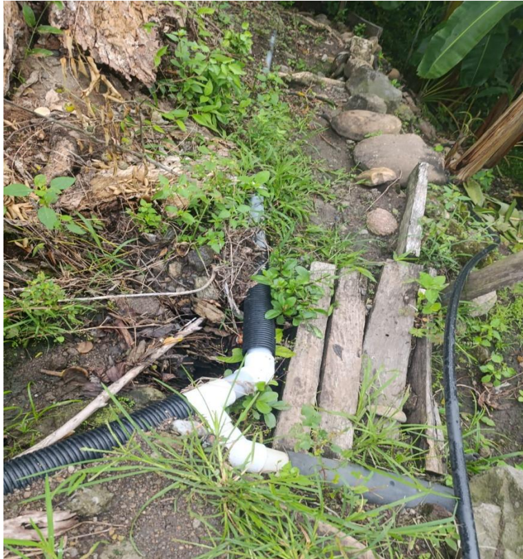
Fotografías 4: Tubería de distribución
