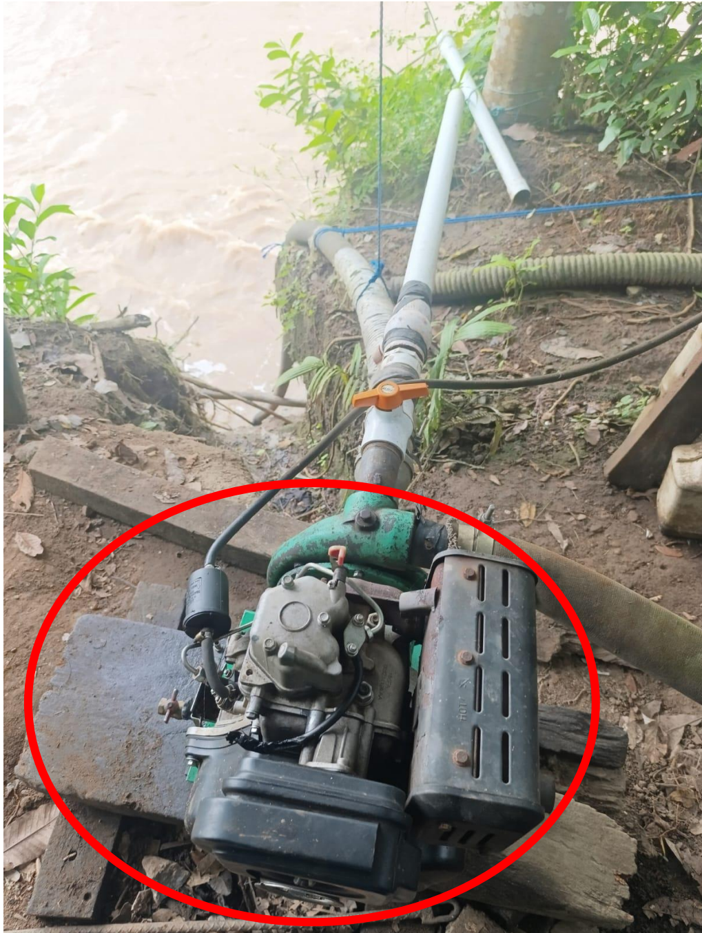
Fotografías 3: Motobomba Diesel
