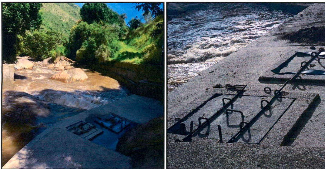
Fotografías 3,4: Cámara de desviación, válvula mariposa - vereda Cascajal – Gigante - Huila
