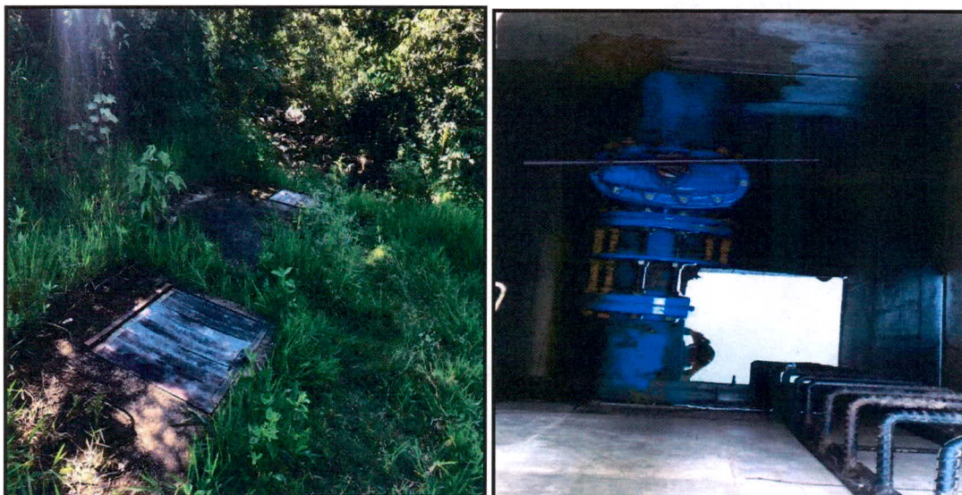
Fotografías 5,6: válvula de lavado caja de limpieza - vereda Cascajal – Gigante - Huila
