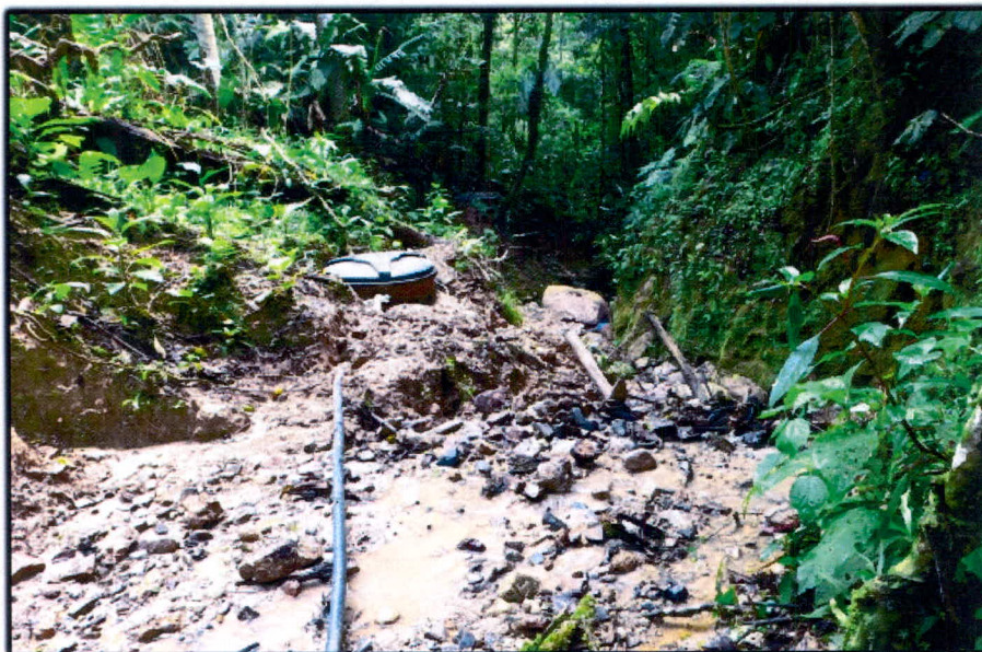
Fotografía No. 3: la línea de aducción por tubería de policloruro de vinilo (PVC) con un diámetro nominal de 3 pulgadas – Suaza (Huila).
