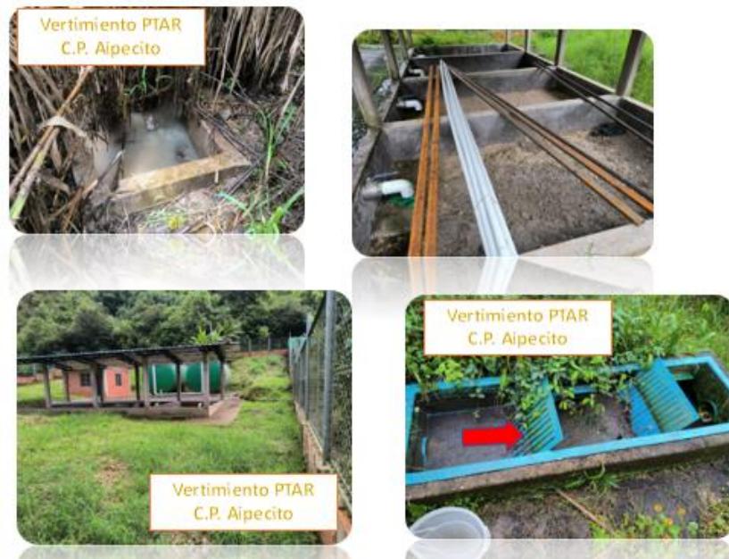
Imagen 13. Inadecuada disposición de residuos líquidos de la PTAR del C.P. AIPECITO sobre la subcuenca del Rio Aipe en el tramo 02. Fuente: CONSORCIO PORH HUILA, 2022.
