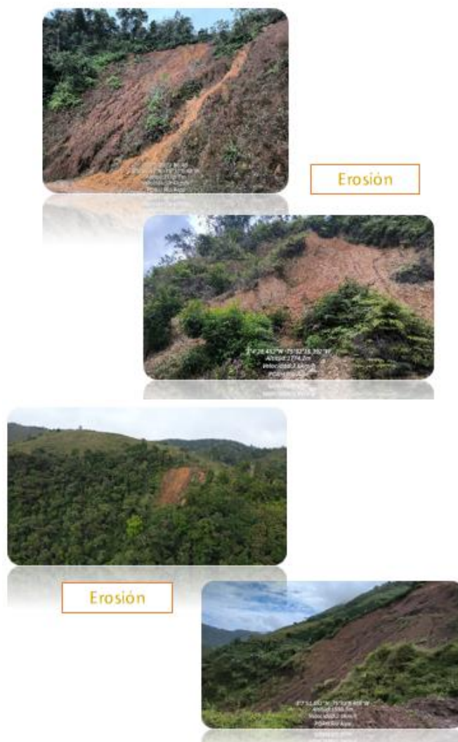
Imagen 6. Proceso erosivo sobre la subcuenca del Río Aipe en el tramo 02. Fuente: CONSORCIO PORH HUILA, 2022.
