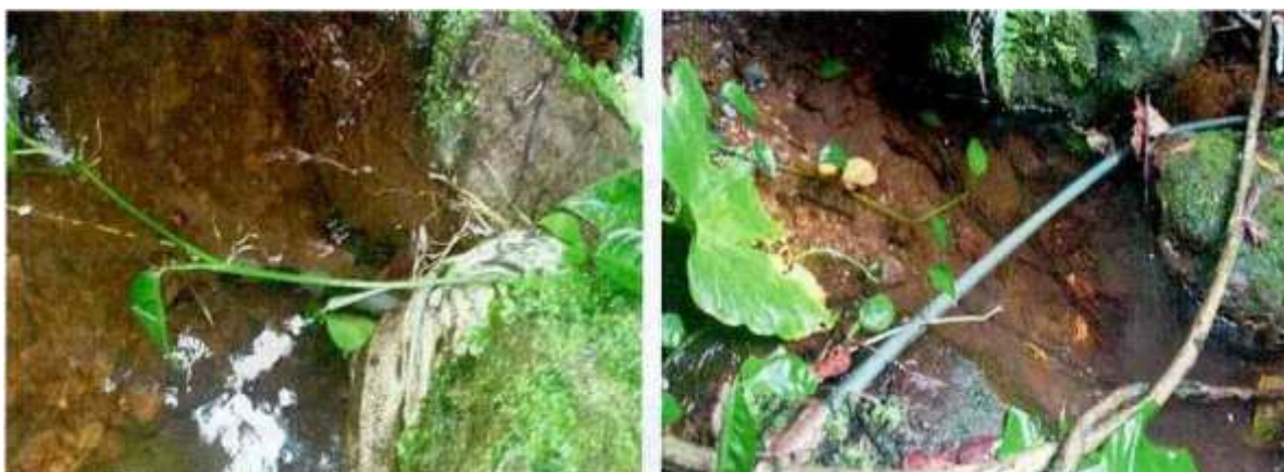
Fotos 9 y 10. Punto de captación sobre el drenaje natural.
