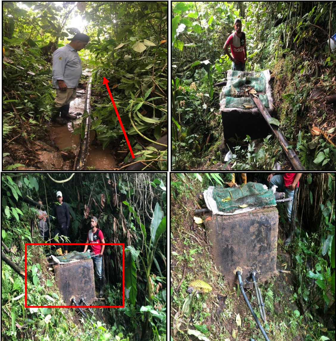
Fotografía 3, 4,5 y 6. Punto de captación—obra hidráulica- vereda Santa Martha-Garzón-Huila
