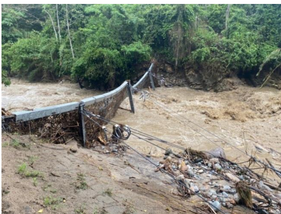
Funcionamiento de la barrera dinámica Km 018+00 vía (Neiva-Balsillas) sometida por la creciente del río Las Ceibas, 22 de noviembre de 2022
