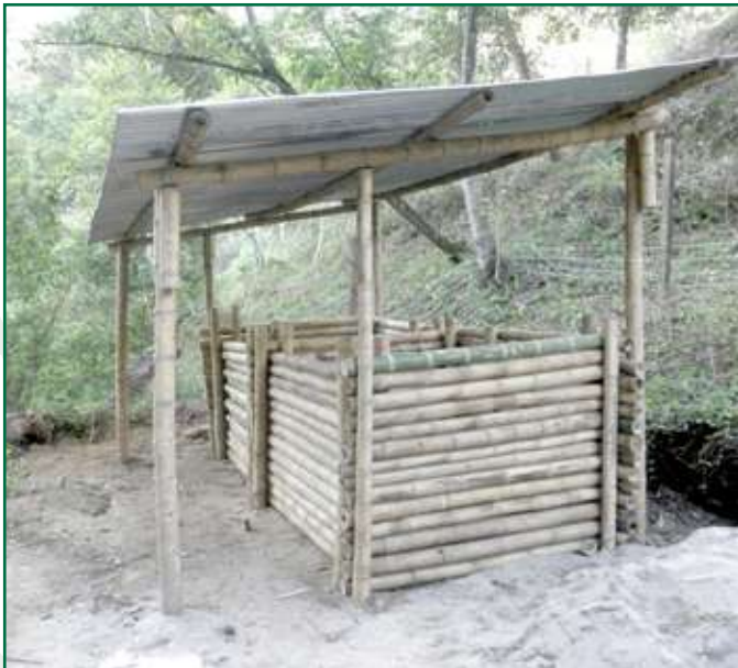
Manejo de plumas y mortalidad en predios avícolas mediante compostera, predio Santa Helena, vereda Santa Helena
