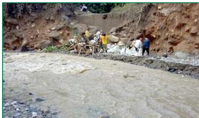
Daños Derivaciones, Río Frío, Campoalegre.
