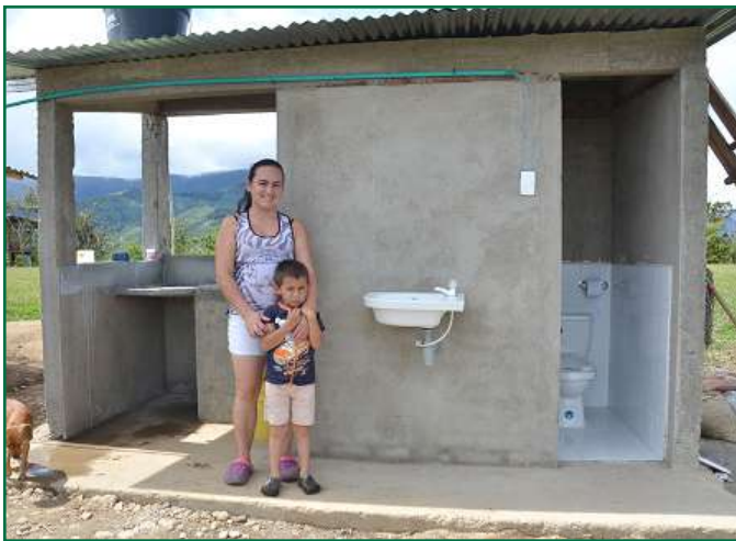
Batería sanitaria - vereda Primavera
