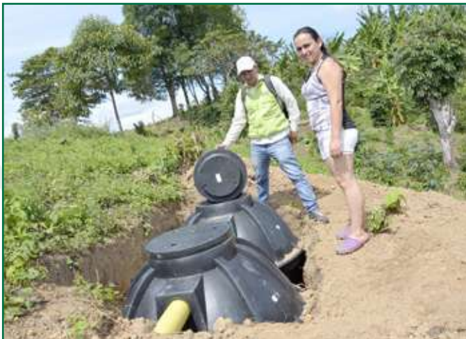
Sistema séptico IMHOFF instalado en predio de la vereda Primavera
