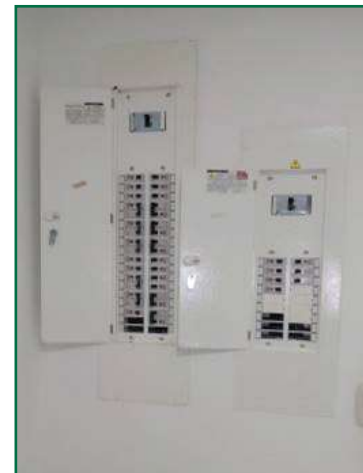
Redes eléctricas – Tableros
