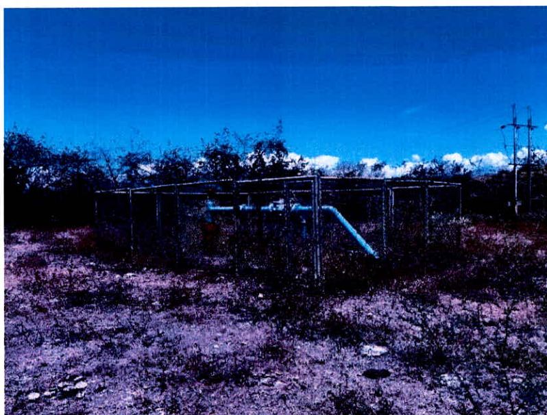
Registro fotográfico No. 2 Pozo Arenas -2, donde se evidencia que el pozo se encuentra inactivo, y no cuenta con equipo de conexión eléctrica. Fuente: Propia.
