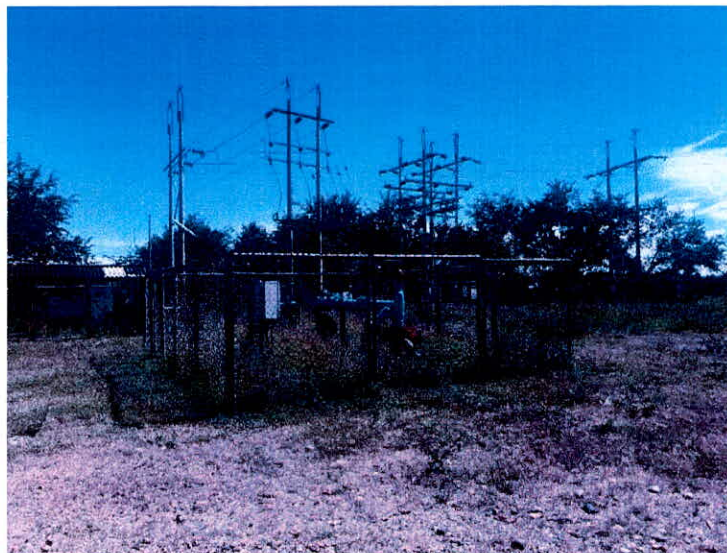
Registro fotográfico No. 4 Pozo Arenas -4, donde se evidencia que el pozo se encuentra activo, cuenta con conexión eléctrica y tubería de conducción. Fuente: Propia.
