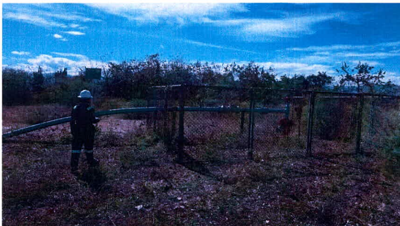
Registro fotográfico No. 5 Pozo Arenas -5, donde se evidencia que el pozo se encuentra activo, cuenta con conexión eléctrica y tubería de conducción. Fuente: Propia.
