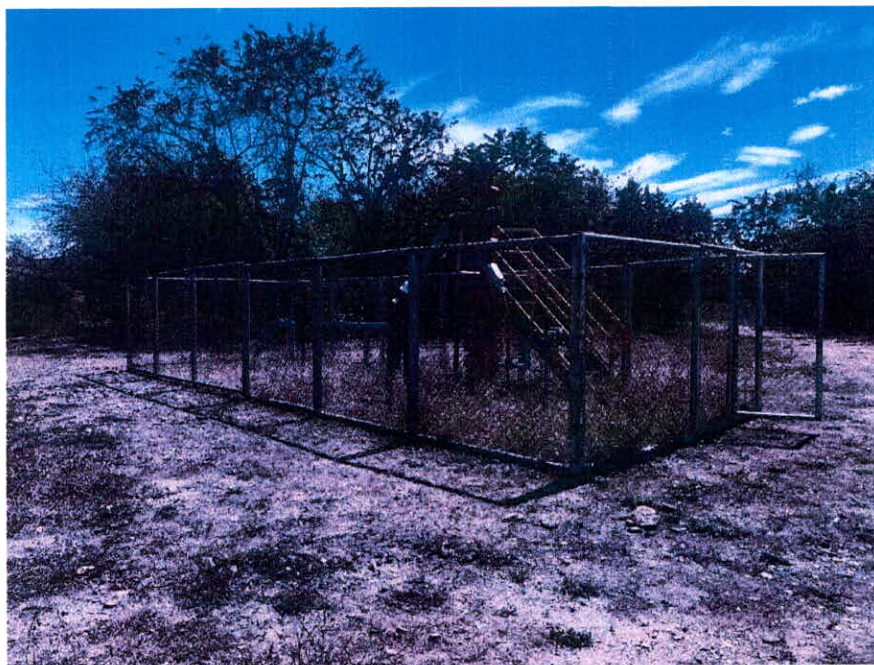
Registro fotográfico No. 6 Pozo Arenas - 6, donde se evidencia que el pozo se encuentra activo, cuenta con conexión eléctrica y tubería de conducción. Fuente: Propia.
