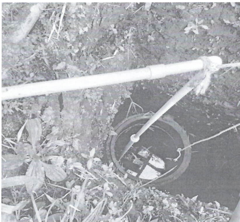
Registro fotográfico No. 1. Pozo objeto a concesionar a cargo del señor José Antonio Quinayas, ubicado en el establecimiento "Lavadero Machetico", en la calle 13 No. 15 - 94, municipio de San Agustín (Huila).
