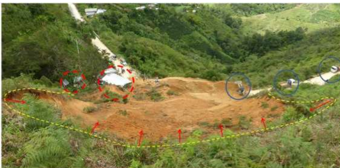
Fotografía tomada desde la «corona» del deslizamiento en un sector de la vía Acevedo-Pitalito en la vereda Alto Bellavista (Acevedo). Se observa la vivienda del señor Fernando Bravo, que estuvo cerca de ser destruida por el movimientos de material caído de la ladera. En el momento de la visita, maquinaria del departamento del Huila desarrollaba labores de remoción de material para dar paso vehicular.
