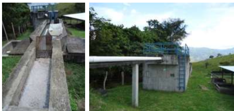
PTAR del municipio de Elías
