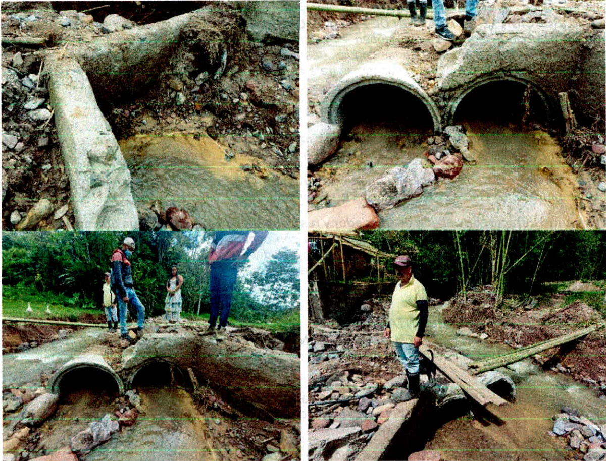
Fotografía 4 a 6. Se observa la instalación de los tubos y el muro en concreto ubicados sobre el cauce de la fuente hídrica Aguas Negras.
