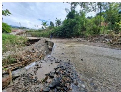
Asistencia técnica Municipio de Elías, Quebrada Calenturas, por Avenida Torrencial.
