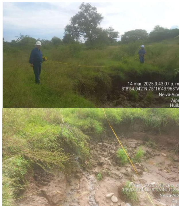
Fotografía 2-3. Zona de afectación por aguas de escorrentía del PK 310+536 Salgar – Neiva
