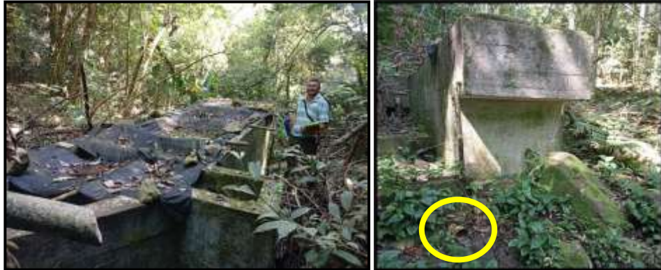
Fotografía 8 y 9. Tanque desarenador y tubería de desfogue del sistema del Acueducto Colectivo Los Olivos El Socorro, vereda El Socorro del, Municipio de El Agrado.
