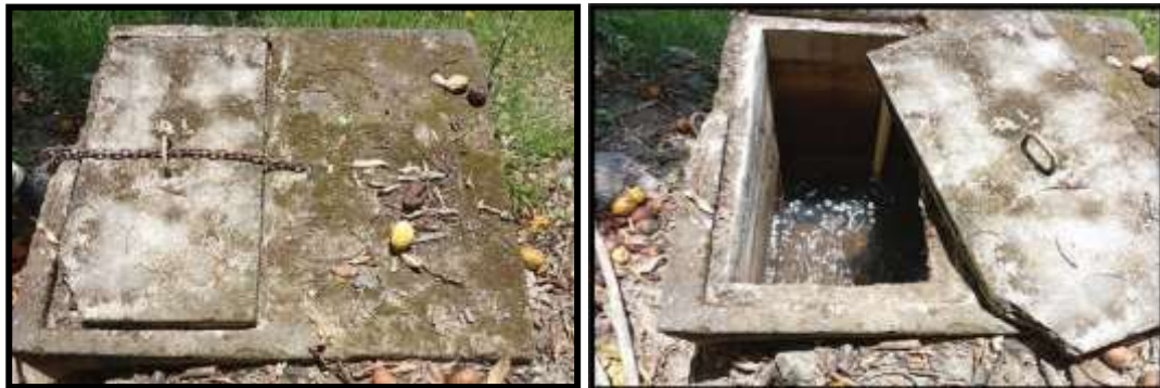
Fotografía 10 y 11. Cámara de quiebre Acueducto Colectivo Los Olivos El Socorro, vereda El Socorro del, Municipio de El Agrado.
