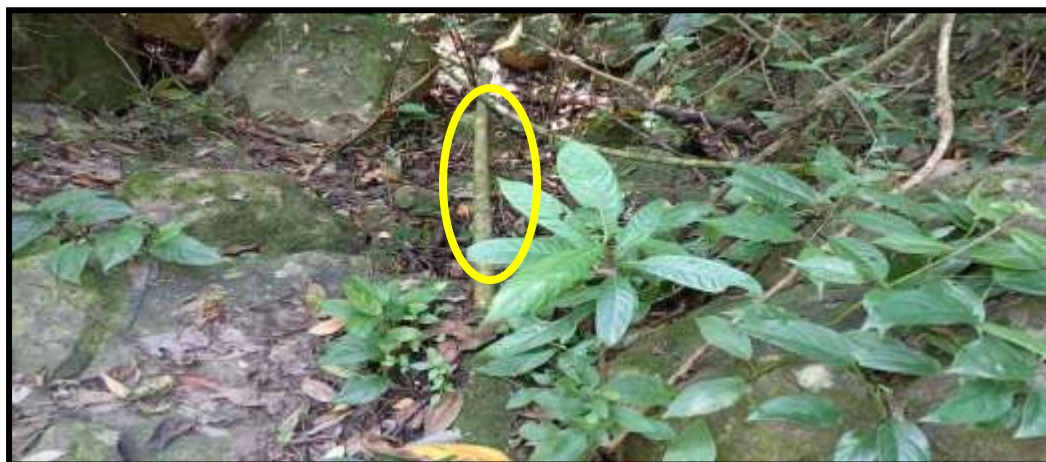
Fotografía 7. Red de aducción Acueducto Colectivo Los Olivos El Socorro, vereda El Socorro del Municipio del Agrado.
