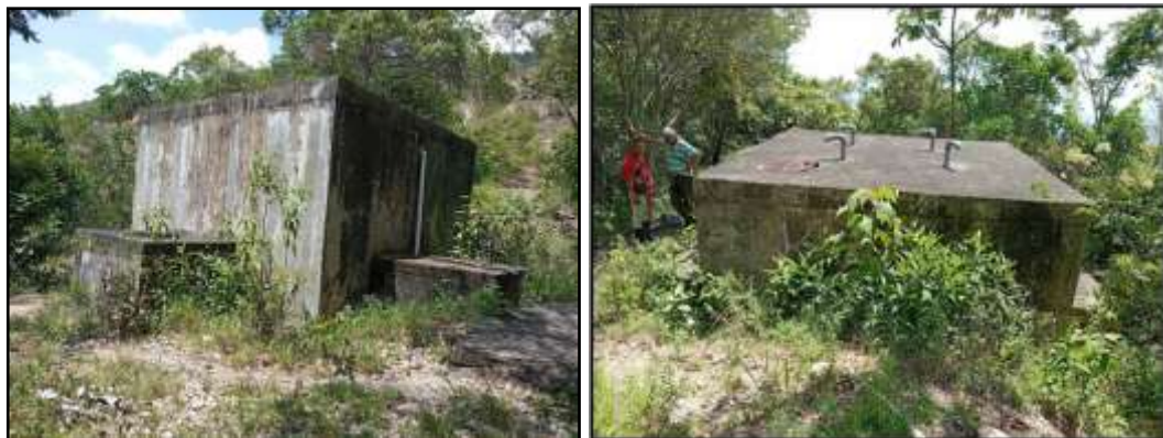
Fotografía 12 y 13. Tanque de almacenamiento y distribución Colectivo Los Olivos El Socorro, vereda El Socorro del, Municipio de El Agrado.
