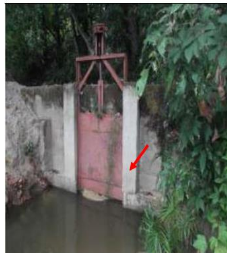
Compuerta derivación El Jordán
