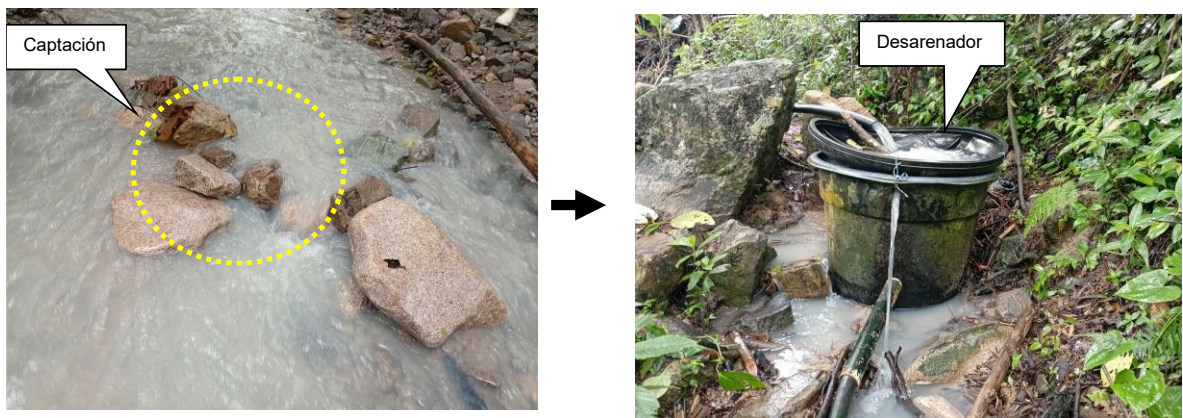
Fotografía No. 1 y 2. Punto de captación y Desarenador
