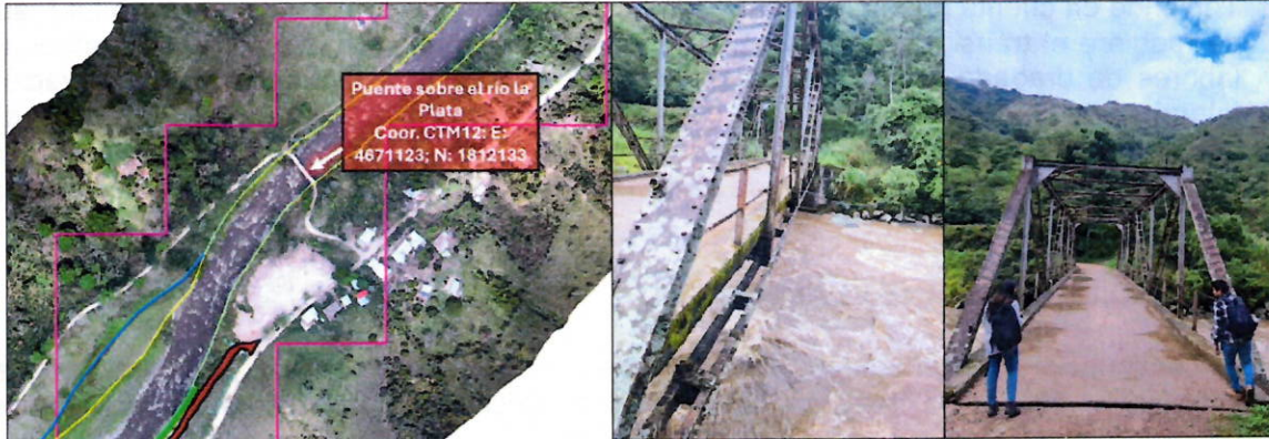
Imagen 28. Restricción para el paso de vehículos mineros en el puente.
