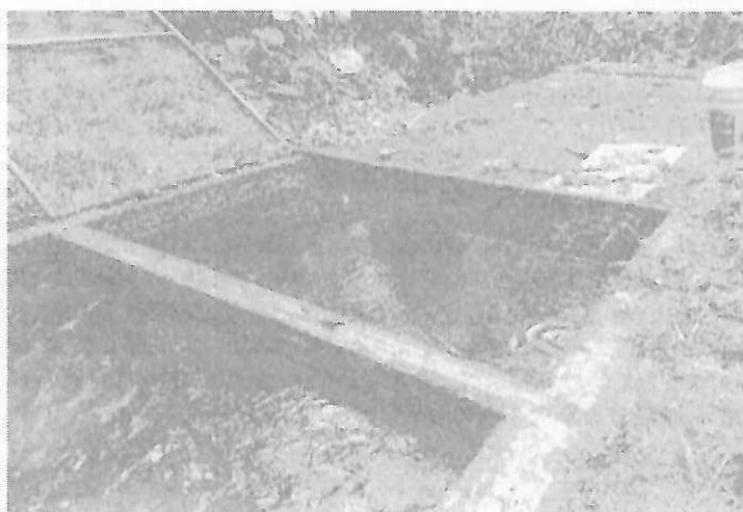
Fotografía 3: Tanque principal de almacenamiento y distribución.
