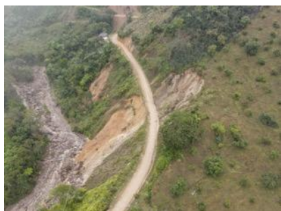
Asistencia técnica al Municipio de San Agustín, vereda Alto Frutal, por deslizamiento
